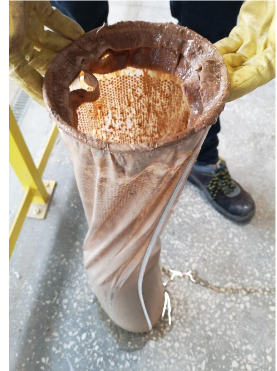
filtr workowy na obiegu wody lodowej
