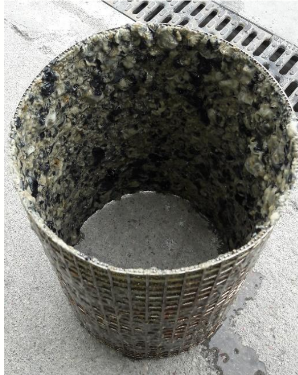
filtr na pompach wody lodowej
