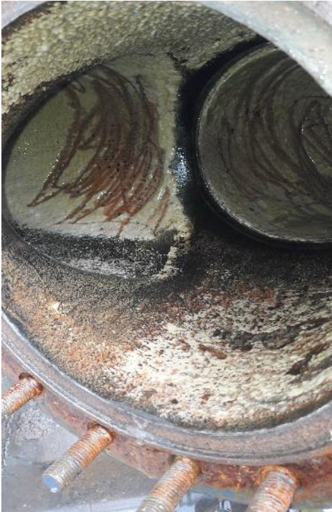
wlot wody lodowej do wymennika ciepła
