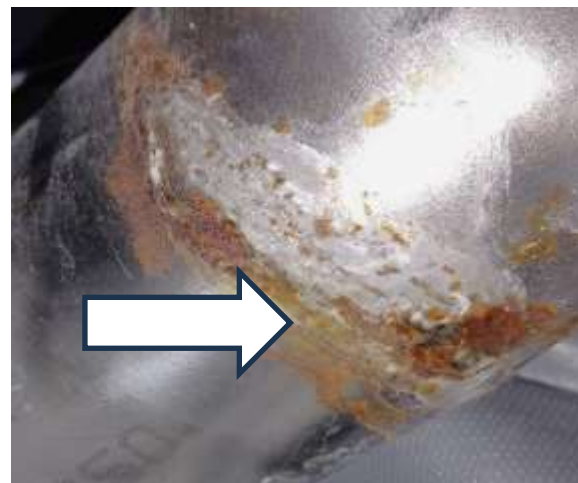
Wyciek korozyjny w miejscu spawu
